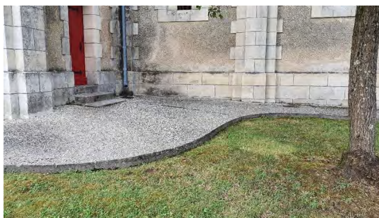
Exemple d'une gestion des eaux de toiture en surface et de manière diffuse dans un espace vert de surface importante (Saint-Palais)
